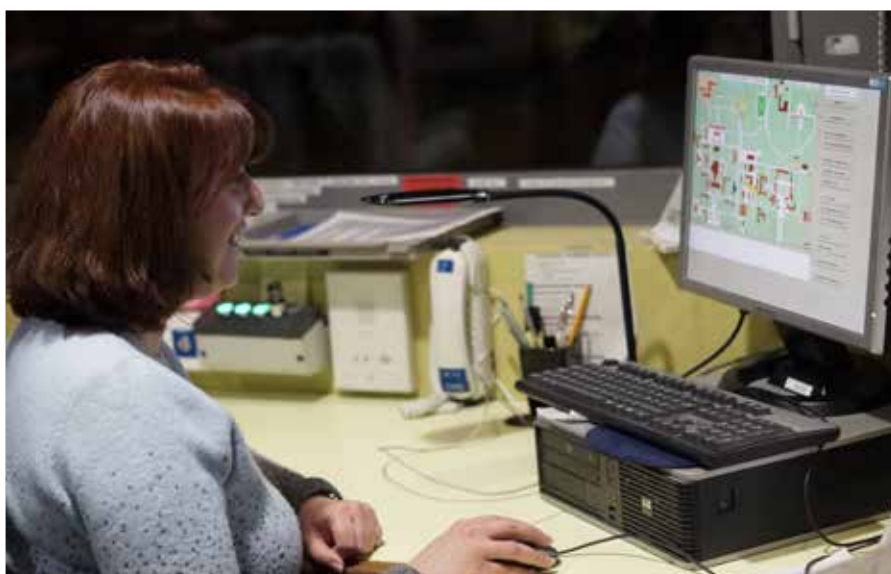
Visualisation du «panorama» (logiciel de gestion des alarmes feu, intrusion, chambres froides et techniques).
